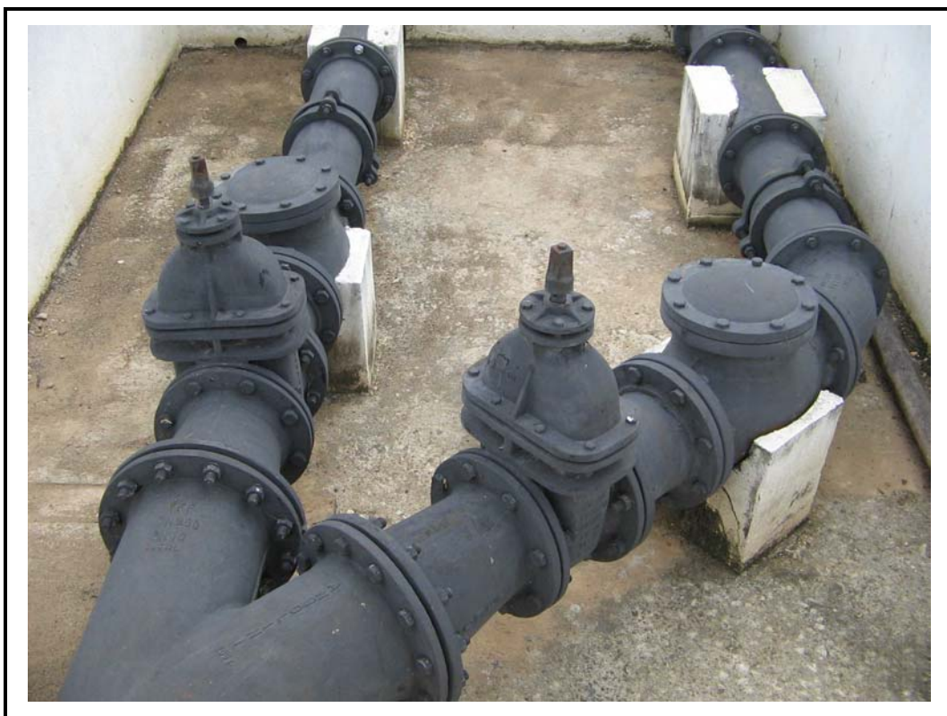
Foto 04 - Caixa de reunião (barrilete em ferro fundido) dos tubos de PEAD.
