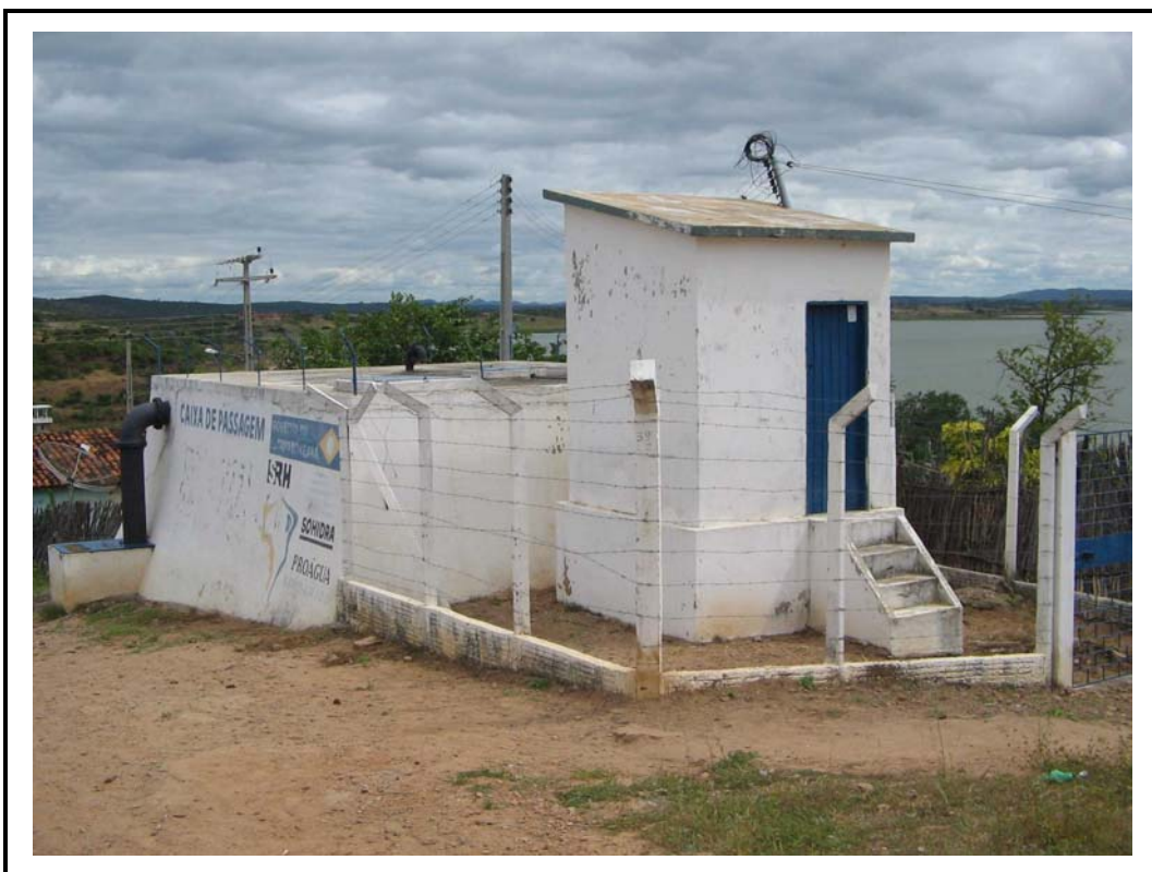
Foto 28 - Caixa de passagem - conjunto.
