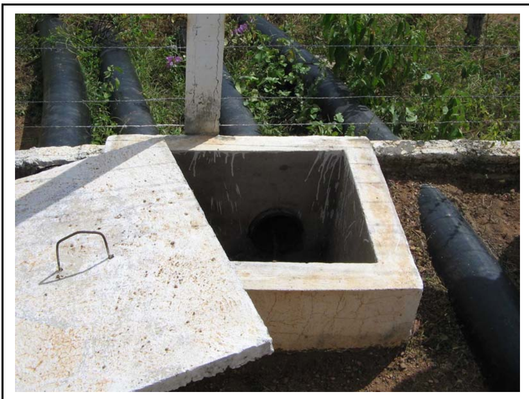
Foto 11 - Pode-se observar 04 tubos de PEAD, sendo os 02 externos que conduzem água e os 02 centrais que levam os cabos de energia.
