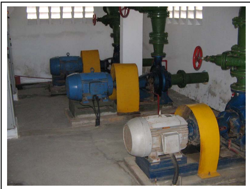
Foto 23 - Elevatória de água tratada.
