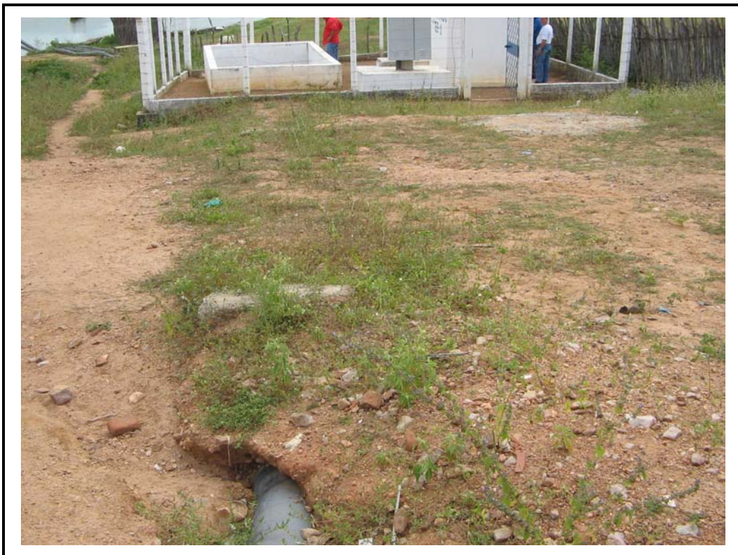
Foto 05 - Adutora de recalque em FoFo, vendo-se ao fundo a casa de comando e subestação (direita) e a caixa de reunião/barrilete à esquerda.
