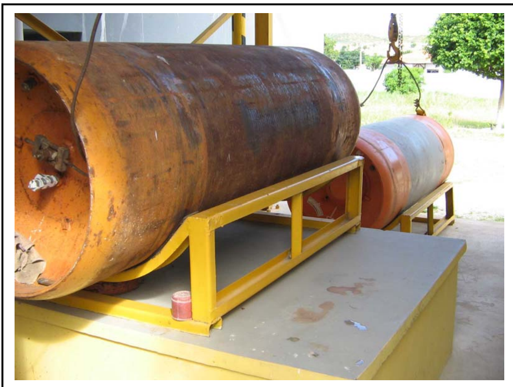
Foto 27 - Local dos cilindros de cloro e detalhes de manuseio.
