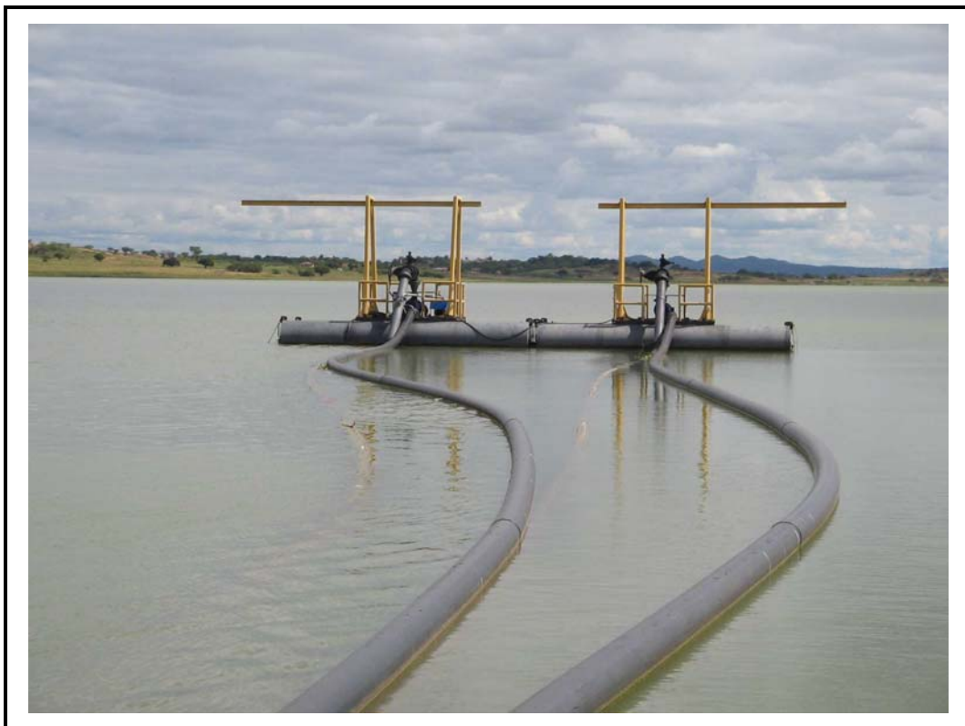
Foto 01 - Captação flutuante, vendo-se os flutuantes individuais de recalque de água de PEAD.
