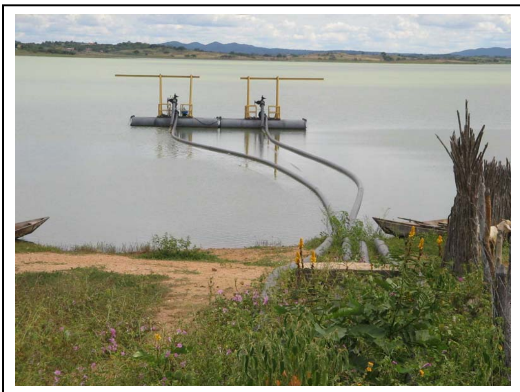
Foto 02 - Captação flutuante no açude Lima Campos.
