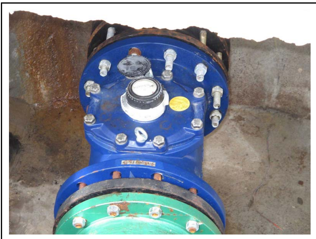
Foto 24 - Medidor de vazão.
