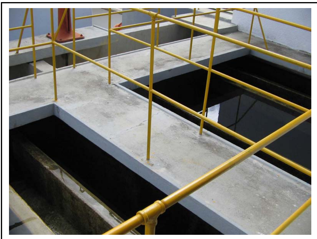
Foto 13 - ETA-Icó - Sistema de Clarificador de Contato e Filtro Lento Ascendente.
