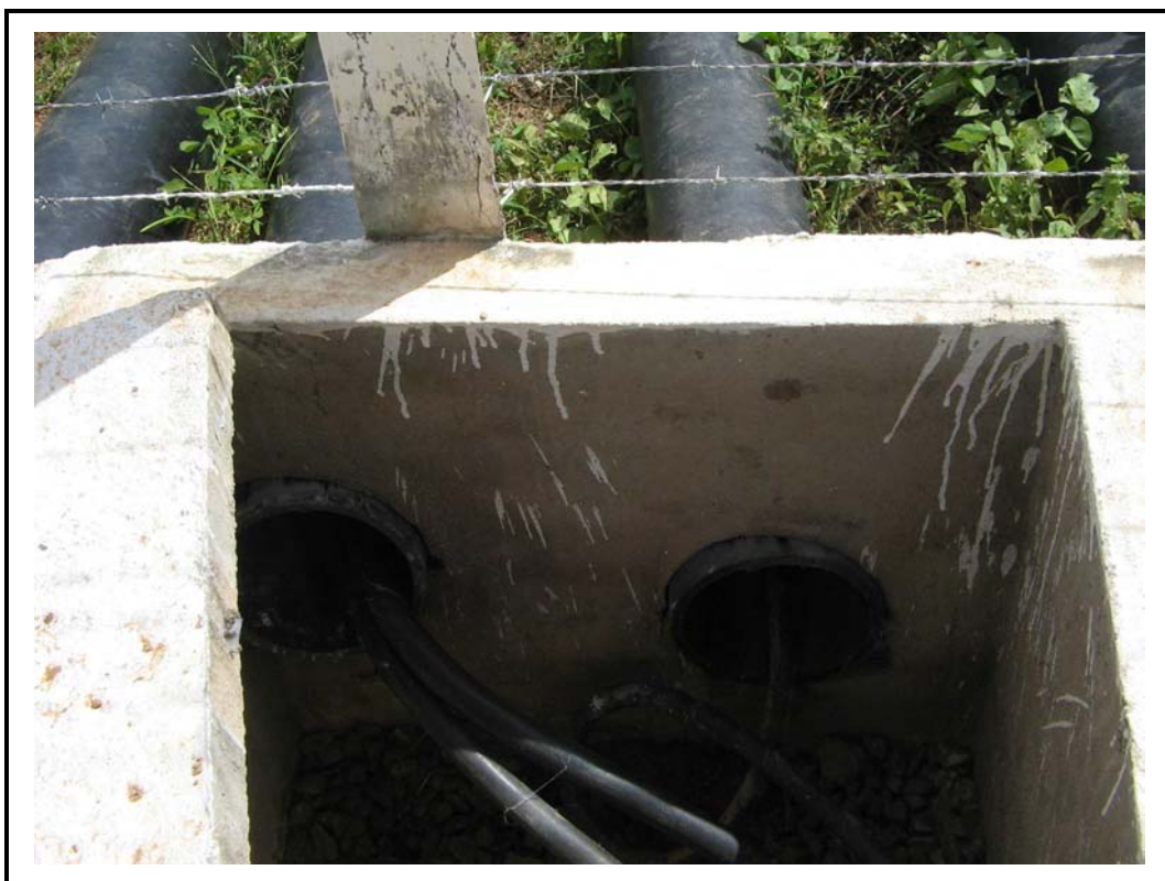
Foto 10 - Detalhe dos cabos de energia na caixa de inspeção dos tubos de PEAD que são os eletrodutos.
