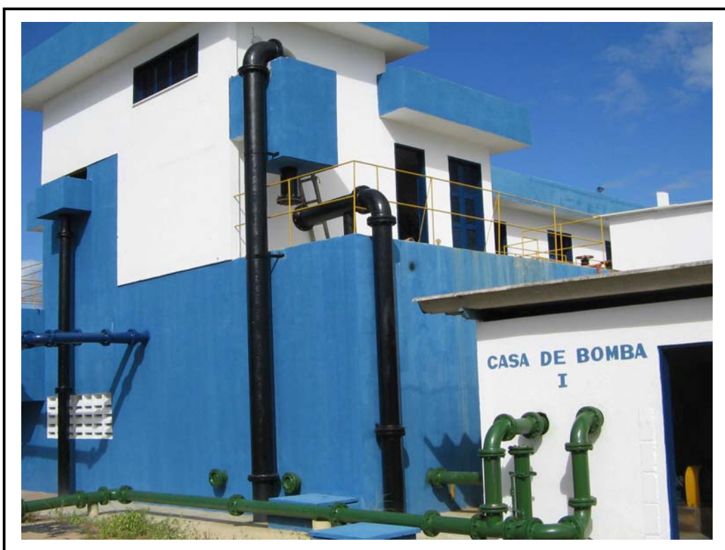
Foto 20 - Casa de Bomba I - Elevatória de água tratada.
