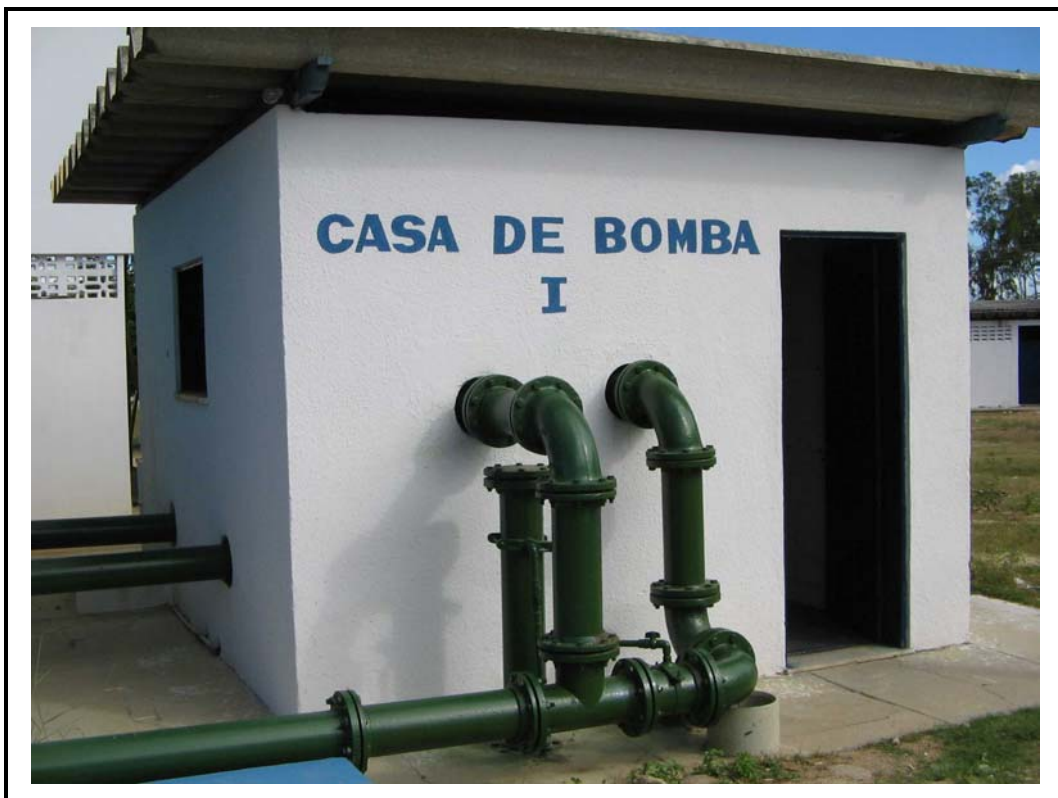
Foto 21 - Casa de Bomba I - Elevatória de água tratada.
