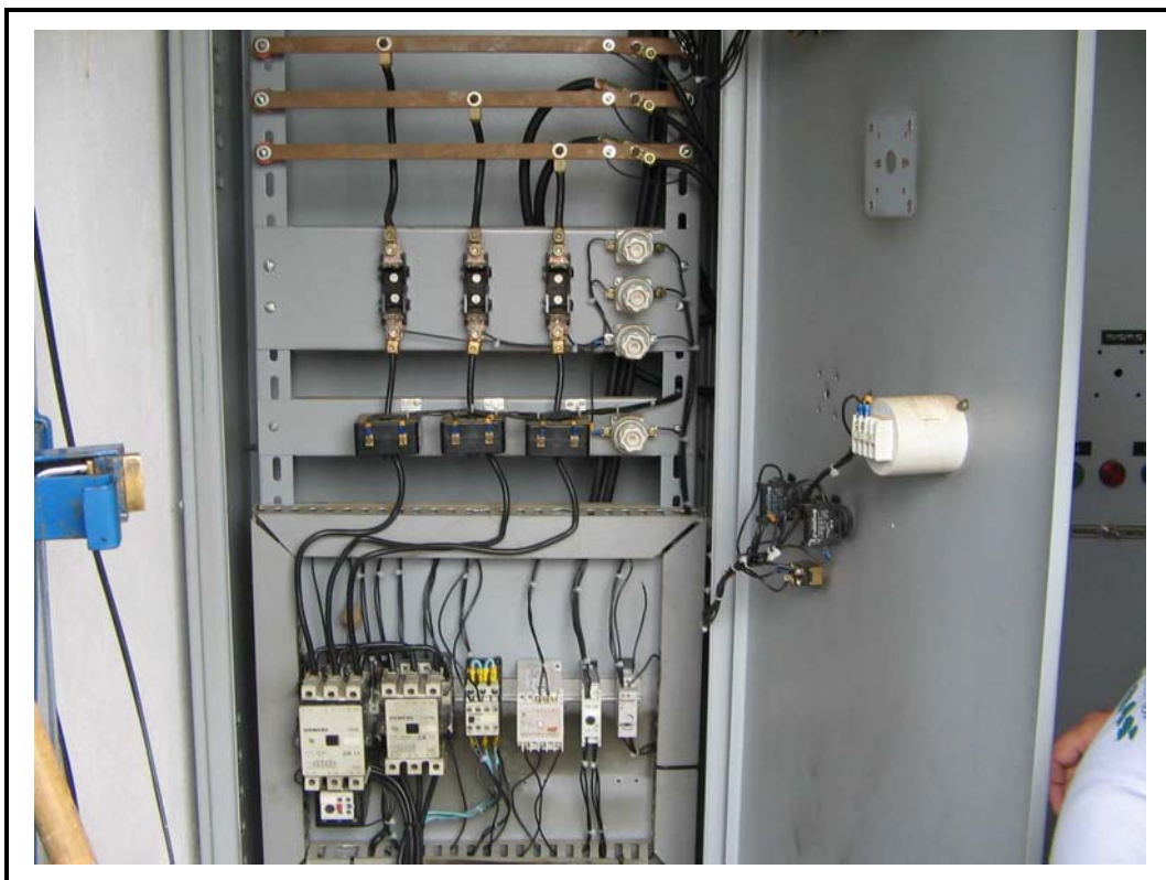
Foto 25 - Painel de comando das bombas instaladas no flutuante.
