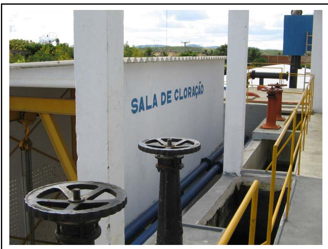
Foto 16 - ETA - sala de cloração.
