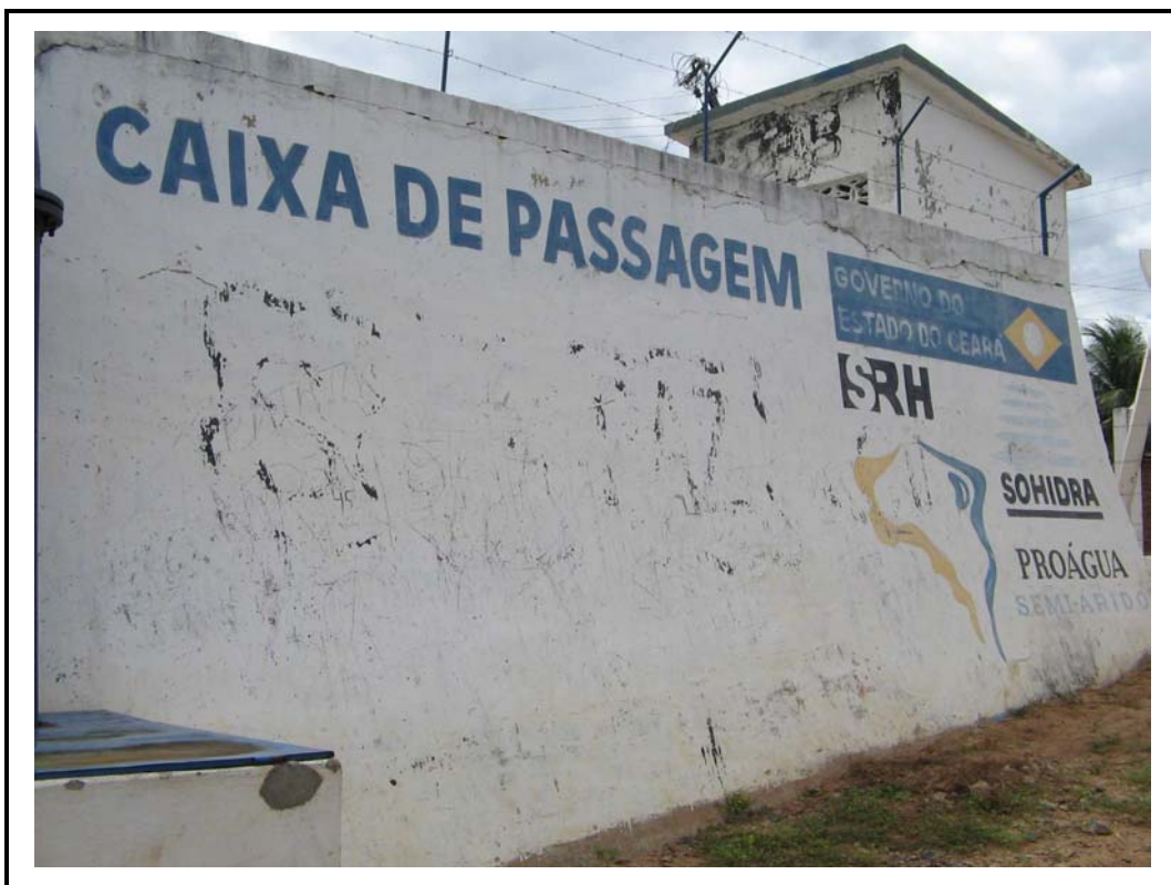
Foto 08 - Caixa de passagem.
