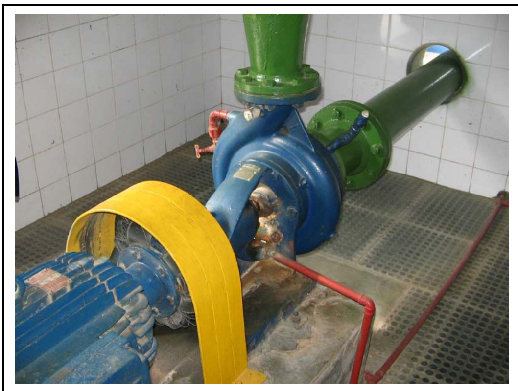
Foto 22 - Elevatória de água tratada.
