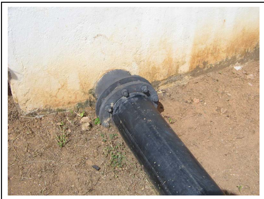
Foto 03 - Chegada do tubo de PEAD à caixa de reunião/barrilete onde se inicia o trecho de adutora de água bruta em FoFo.
