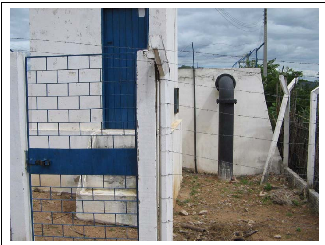
Foto 09 - Caixa de passagem, vendo-se a tubulação de entrada em ferro fundido.
